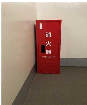
消火器収納 ボックス
